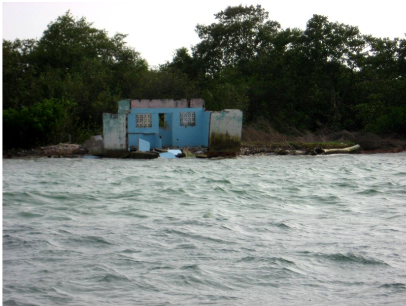
Figura 35. Efectos de la erosión generada por deficiencia de sedimentos en el sector SE del norte de la isla de Tierrabomba. Sitio cercano al Hotel Las Tres Banderas.
